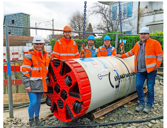
Zur Bohrkopftaufe versammelten sich (v.l.): Stephanie Walker, Fachbereichsleiterin Stadtentwässerung, Baudepartement Stadt Zug, Adrian Husner, Bauführer Spezialtiefbau, JMS Risi AG, Hannes Brandenburg, Polier, und André Hartmann, Bauführer, beide Landis Bau AG.
